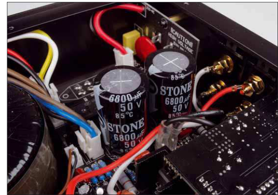
Zwei üppig dimensionierte Kondensatoren wurden im Netzteil verbaut
